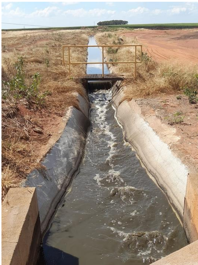
Figura 3 – Canal de vinhaça impermeabilizado com concreto. Lençóis Paulista - SP, 2021. Fonte: arquivo pessoal.
